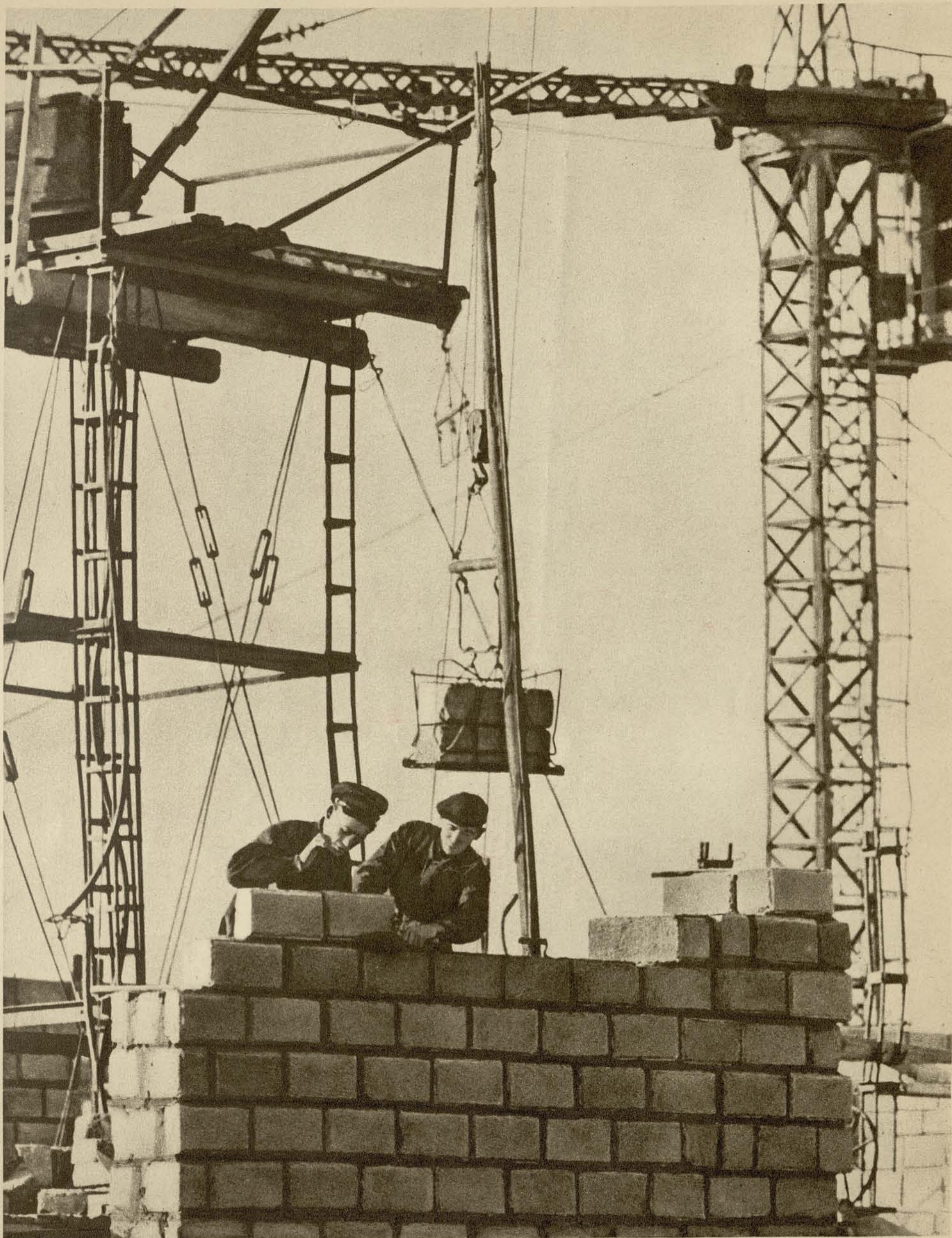
Герой Социалистического Труда каменщик Петр Давыдов на стройке нового горно-промышленного училища при шахте имени Орджоникидзе в Донбассе (см. фотоочерк „Каменщик Давыдов” на стр. 4—5).
