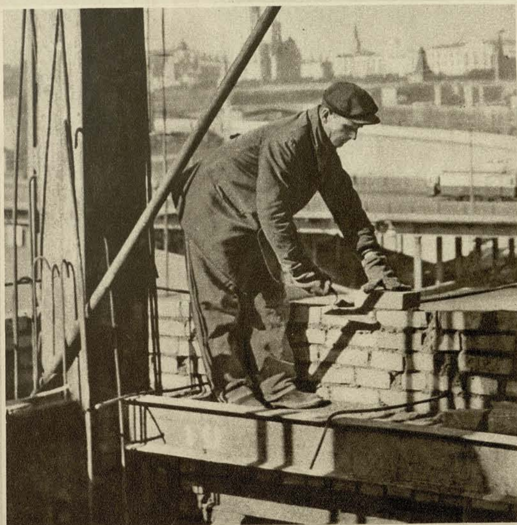
Вслед за монтажниками, сооружающими металлический каркас здания, на строительную площадку приходят каменщики, заполняющие кирпичной кладкой пролеты каркаса. На снимке — один из замечательных мастеров скоростной кладки — каменщик А. Кочубей.
