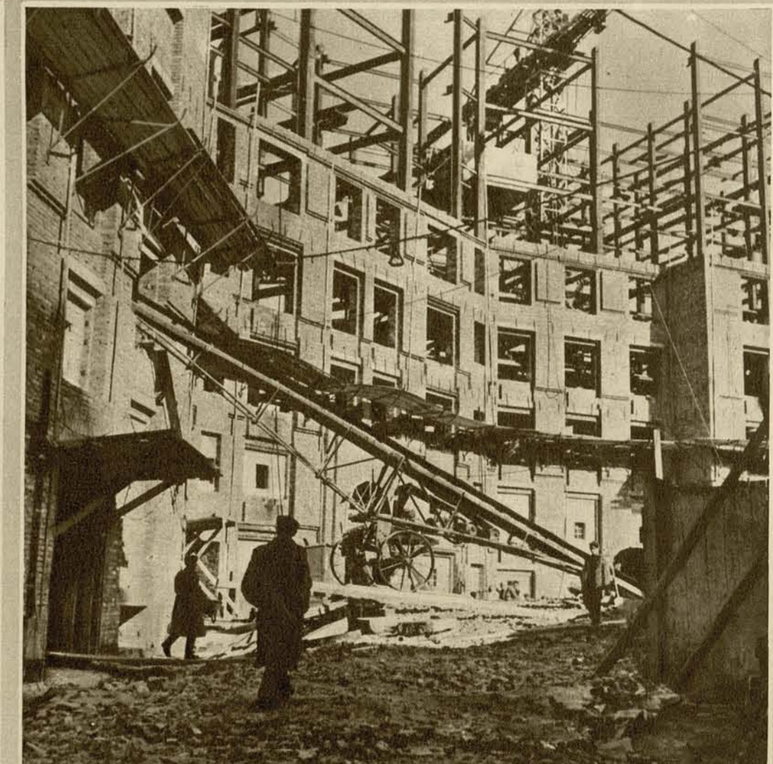
Уголок строительной площадки на Котельнической набережной. На снимке видны кирпичные стены дома, быстро растущие вслед за поднимающимся все выше металлическим каркасом. Кирпичные стены будут облицованы полированным гранитом и керамической плиткой.
