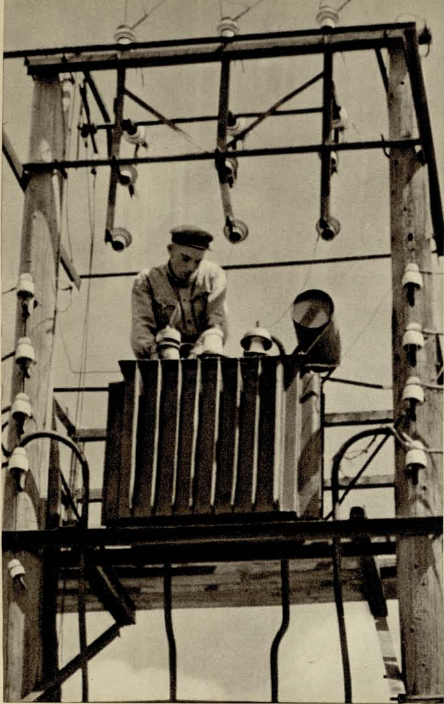
Колхоз полностью электрифицирован. Электричество проведено в дома колхозников, общественные здания, школы, клуб. На снимке: колхозный электромонтер Николай Зайчук за осмотром трансформатора.
