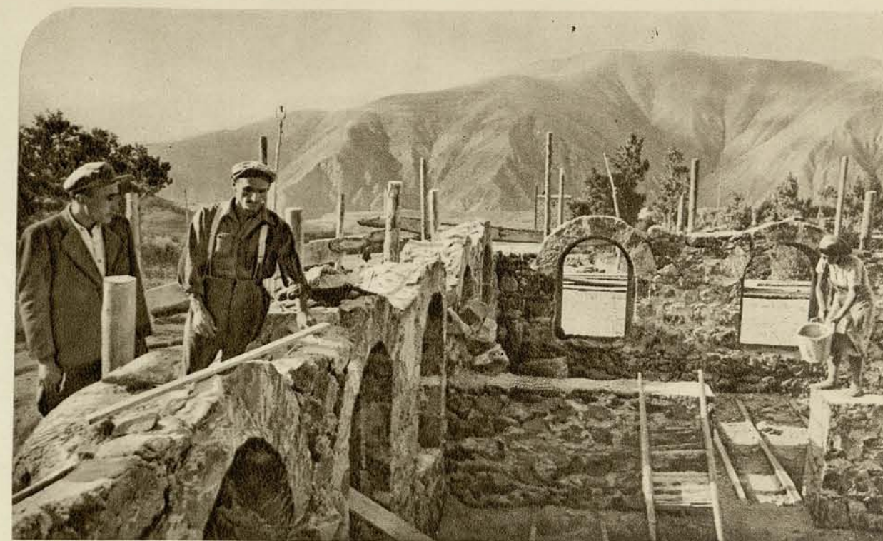
Как и во многих других местах, строится клуб в селе Нор-Аван, Сисианского района.
