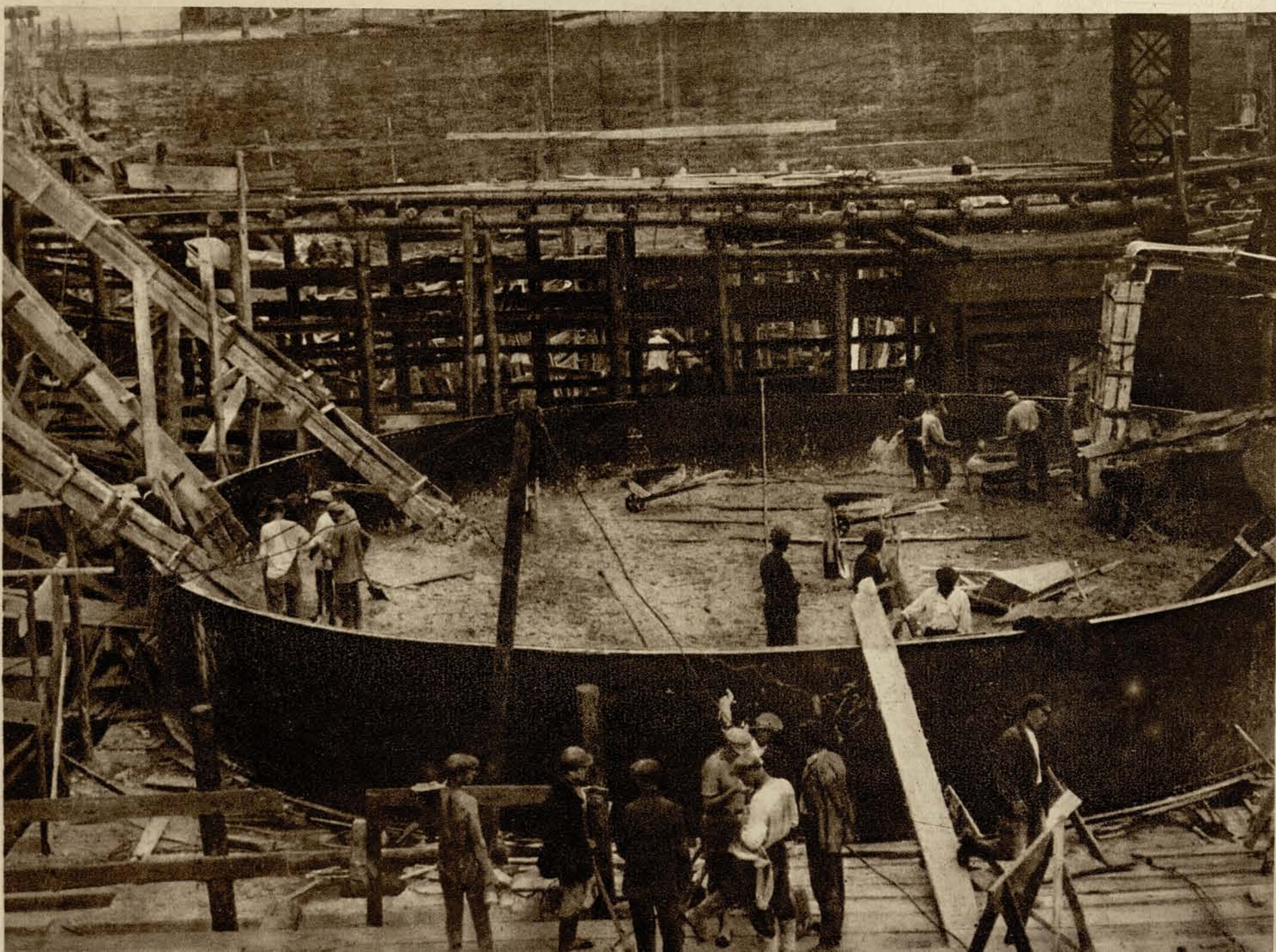
Бетонировка днища четвертой домны. Она будет целиком механизирована. Ее об'ем — 8\frac{1}{2} кубометров. Производственная мощность — 650 тонн чугуна ежедневно. Таких домен нет на старом Краматорском заводе.
