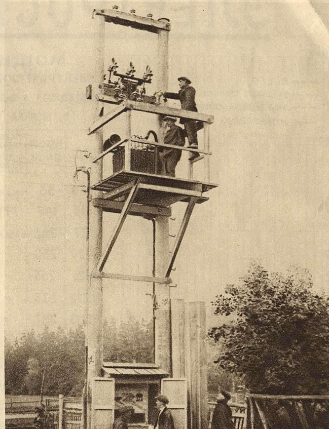
ВОЗДУШНАЯ ПОД СТАНЦИЯ — СТАНДАРТ НАЯ СЕЛЬСКАЯ ЭЛЕКТРОУСТАНОВКА
