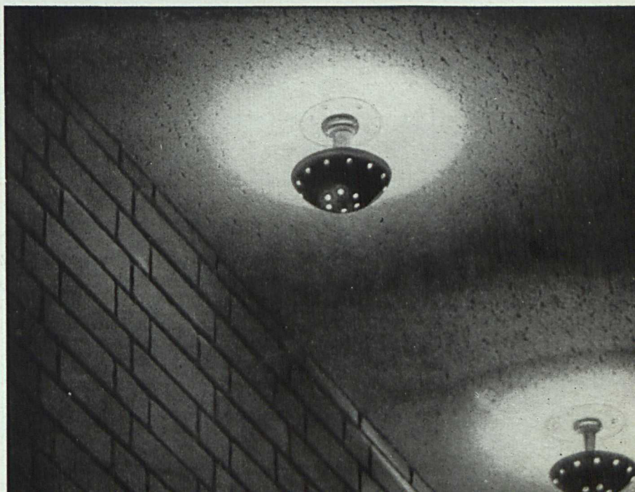
Освещение коридора 1-го этажа.
