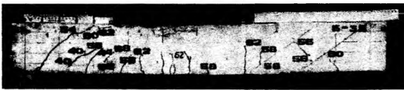
Рис. 4. Образование и развитие трещины в балке Б-35 с двумя наклонными пластинами в сочетании с поперечной арматурой
