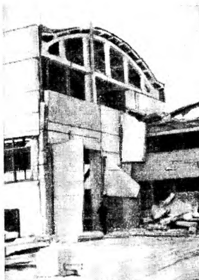
Рис. 5. Разрушение связей навесных стеновых панелей с колоннами производственного здания Ленинанканского завода ЖБИ
