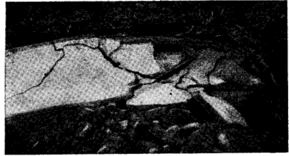
Рис. 3. Вид разрушения опоры построенной из вибрированного железобетона
