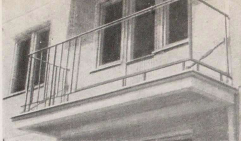
РИГА. Фактура панелей фасада выполнена методом присыпки наменной крошки. Ограждение балкона не закончено (отсутствуют экраны)
