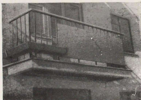
МИНСК. Балкон с асбестоцементным декоративным экраном, навешенным на решетку
