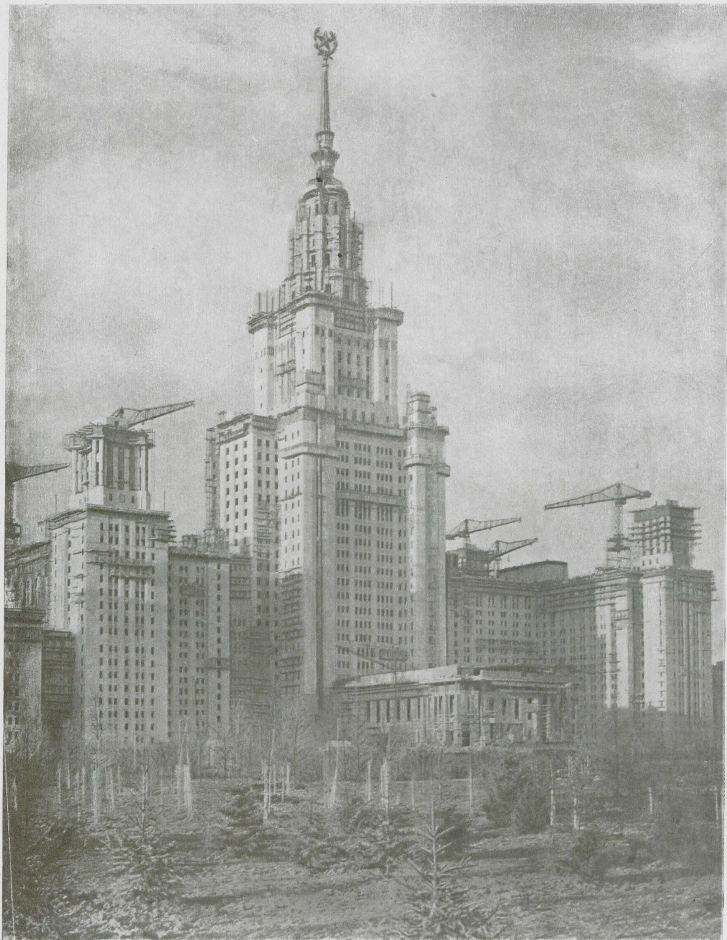
Строительство высотного здания Московского Государственного университета на Ленинских горах. Центральная часть главного корпуса
