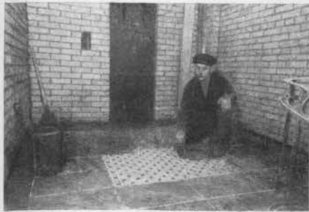
Полы всех лестничных площадок выложены ковровой мозаикой. Стены лестниц из лицевого кирпича с расшивкой швов.
