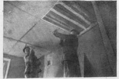
К потолку прибивается сухая огнестойкая органическая штукатурка (плиты из древесных отходов размером 122x480x1,5 см)
