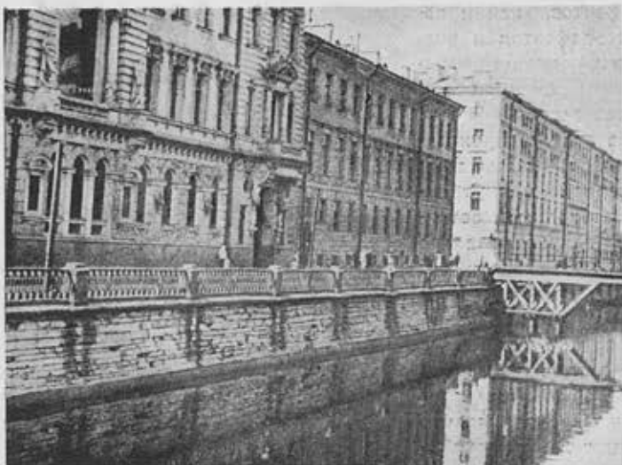
Ржавые потеки на каменной стене против примыкания железных перил к каменным тумбам (Набережная канала Грибоедова в Ленинграде)
