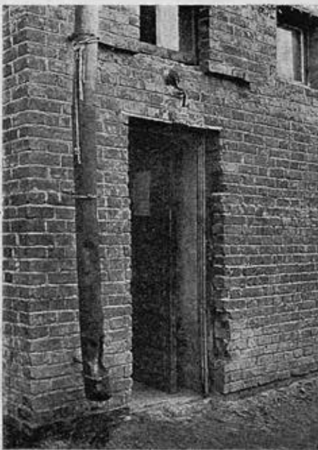
Дом научных работников б. Наркомснаба, Дмитровское шоссе Подлестничные клетки. Отсутствие отмета трубы. Незащищенная арматура электролампы. Быстрый износ дверной рамы из-за отсутствия площадки перед входом Дверная ручка разрушает штукатурку. Дверь заклеена объявлением. Наружная дверь сломана
